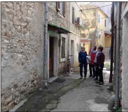
Nel centro storico di Umago, segni di degrado.
